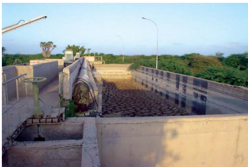
Figure 8. Unité de traitement d'eaux usées hors service depuis des années à Douda.
